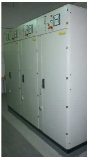
Fot. 8. Automatycznie regulowana bateria kondensatorów ACR 6,3kV z systemem regulacji, blokad, pomiarów, rejestracji zdarzeń i zabezpieczeń członów ELMA NETSYSTEM. Produkcja ELMA energia.
