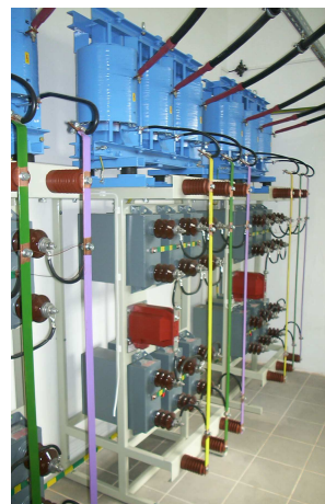
Bateria kondensatorów BSDR średnich napięć 6,3kV. Produkcja firmy ELMA energia w Hucie Głogów S.A.
