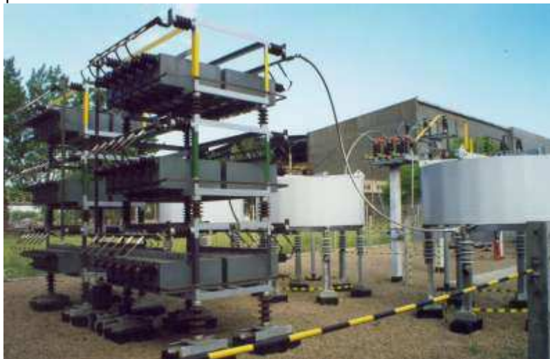
Automatycznie regulowane filtry 3-ciej harmonicznej wysokiego napięcia (42kV – 2x35MVar) pieca łukowego w Hucie Ostrowiec S.A. Realizacja „pod klucz” ELMA energia [2]
