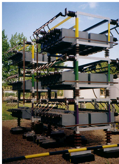
Bateria wysokich napięć 35MVar/42kV. Realizacja firmy ELMA energia w Hucie Ostrowiec S.A. Fot. 1. Przykładowe rozwiązania baterii kondensatorów niskich, średnich i wysokich napięć
