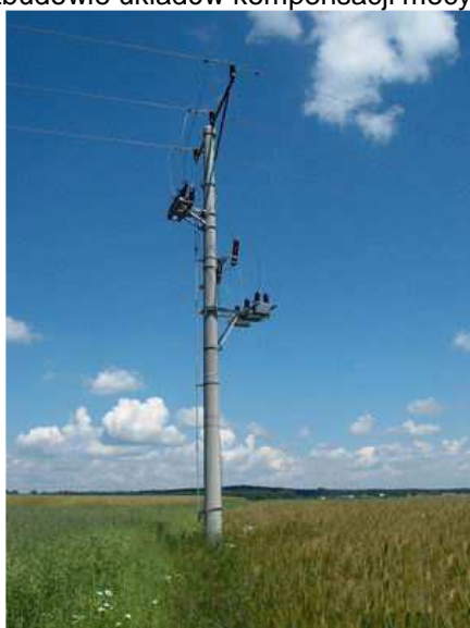
Fot. 3. Napowietrzna, następowa bateria kondensatorów 15kV (ELMA energia)
