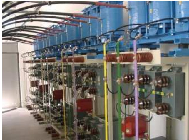
Filtry odstrojone średnich napięć 6,3kV ( f_r = 189\text{Hz} ) instalacji kompensacyjnej w Hucie Miedzi Głogów S.A. (realizacja ELMA energia)
