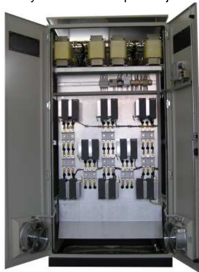
Fot. 9. Baterie KMT-3...D (z dławikami rezonansowymi) 400V w systemie TSC. Produkcja ELMA energia
