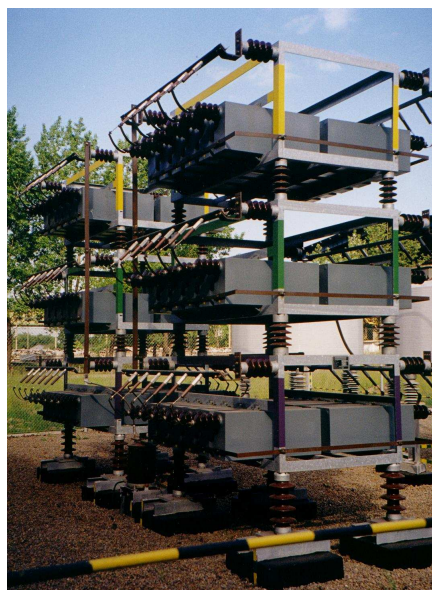
Rys. 4. Bateria kondensatorów z zabezpieczeniami zewnętrznymi
