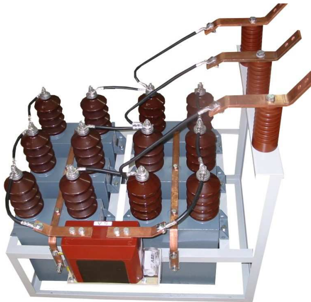
Rys. 1. Jednofazowe kondensatory średnich napięć z dwoma izolatorami, połączone w układ podwójnej gwiazdy z przekładnikiem zabezpieczenia zero-prądowego
